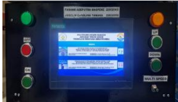
Gambar 7. HMI Haiwell pada Panel Sistem Kendali
