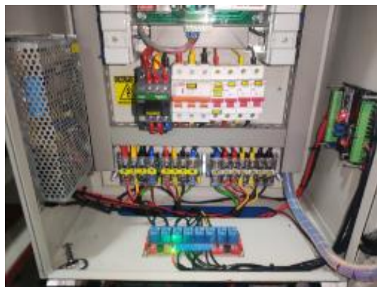
Gambar 6. Relay sebagai Antarmuka Output PLC dan Input Digital VFD
